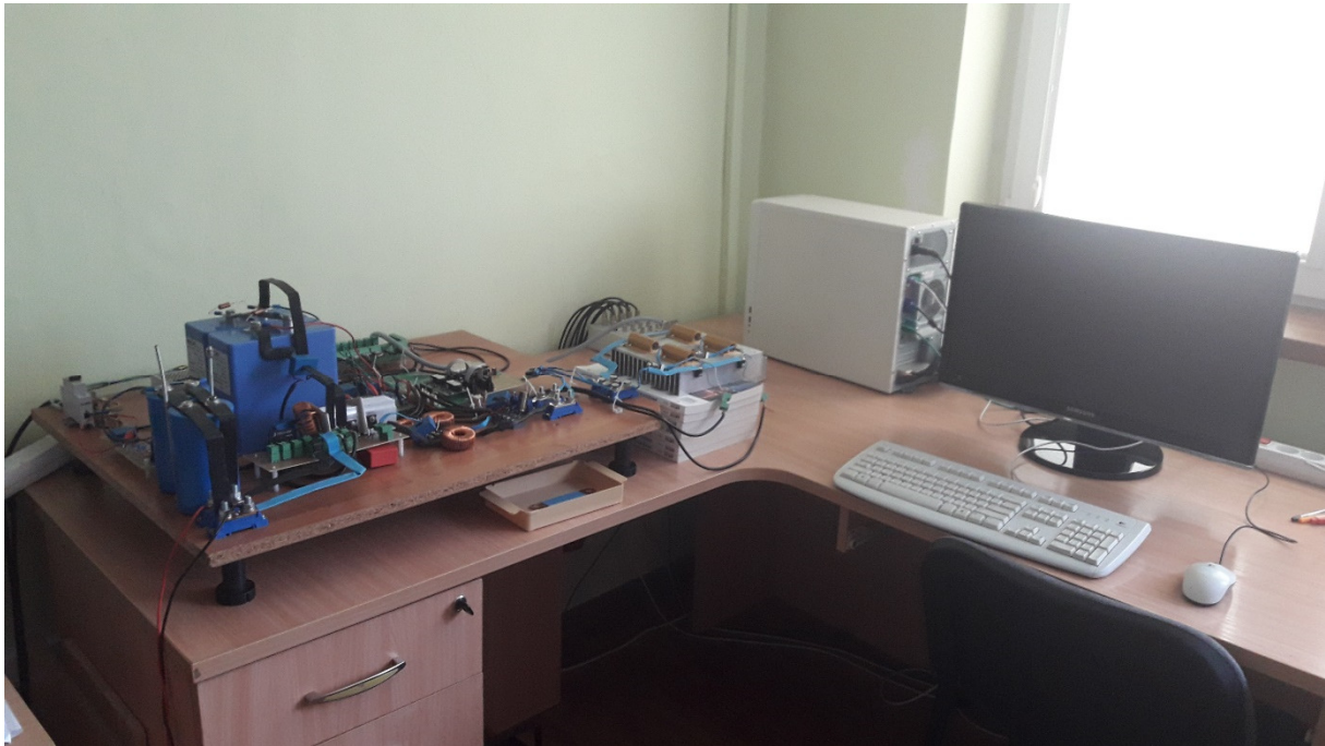
Fotografia 1. Stanowisko laboratoryjne z przetwornikiem DC-DC obniżającym napięcie z wejściowym filtrem LC.
